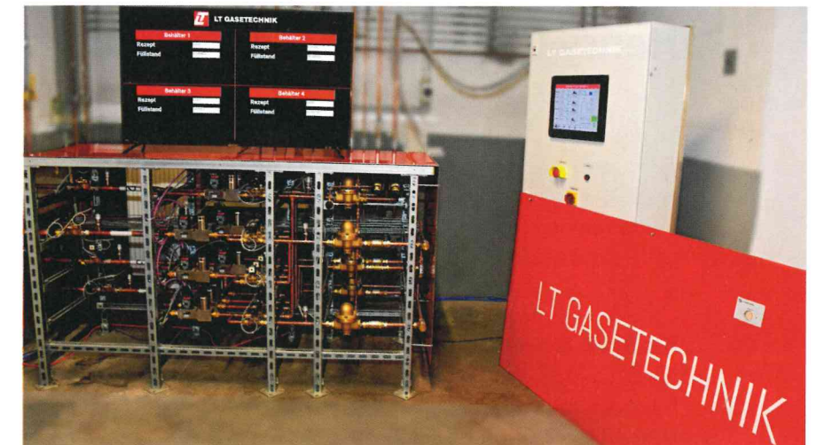
Bild 2: Blick in die Anlage mit Druckreglern, Armaturen und Massendurchflussreglern. Im Hintergrund die Bedieneinheit zur Anlagensteuerung
