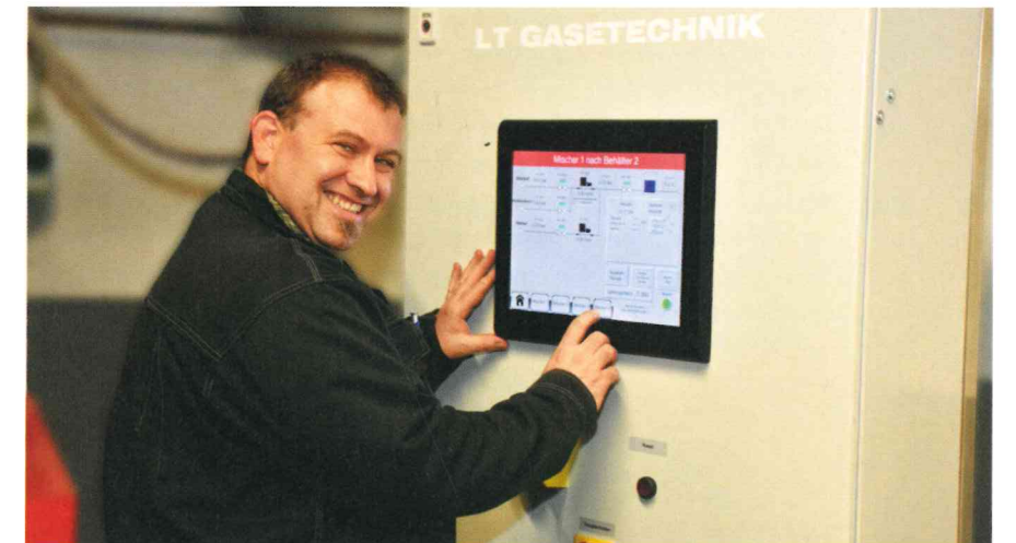
Bild 3: Die Bedienung der Anlage erfolgt über den Touchscreen. Martin Brüggemann vom GWI probiert die Rezeptsteuerung der einzelnen Gasmischstränge aus
